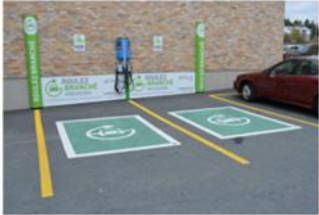
Figure 34 : Bornes de recharge électrique pour véhicules électriques (C-400 PHOTO 40004)
